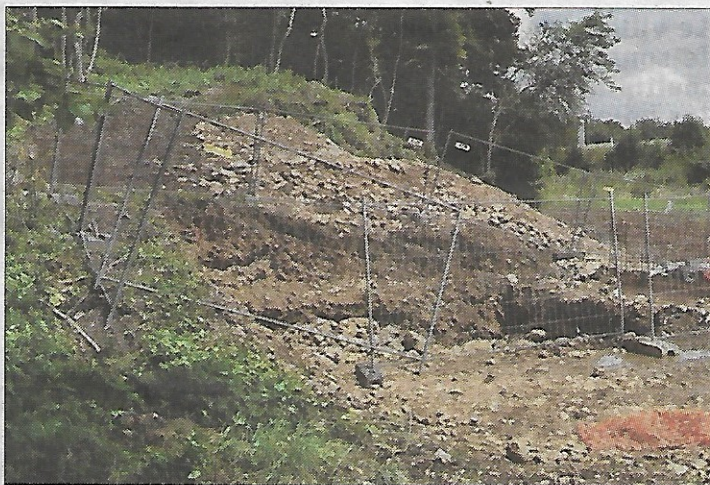
Le chantier a été interrompu suite à l'apparition d'une doline et entièrement sécurisé.
